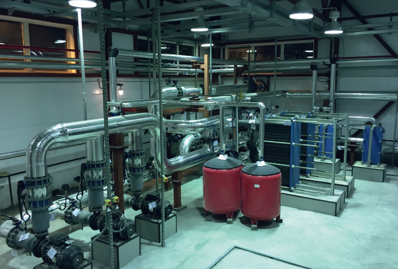
Котельная, г. Апатиты
